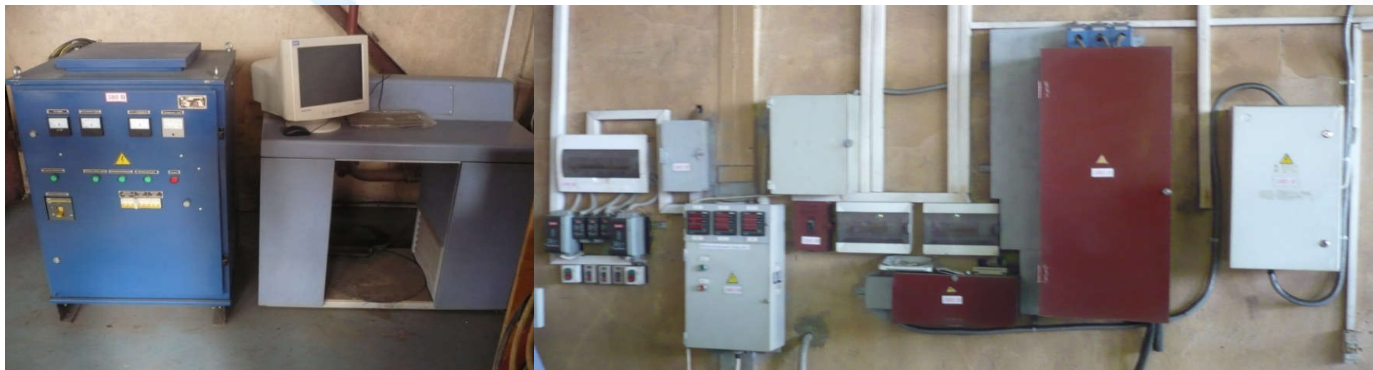
Станция плавного пуска. Стенды с частотным управлением
